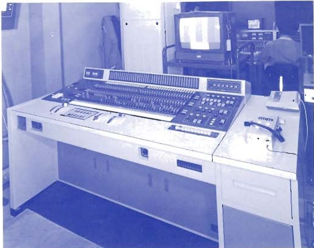
8F 副調整室の照明操作卓
