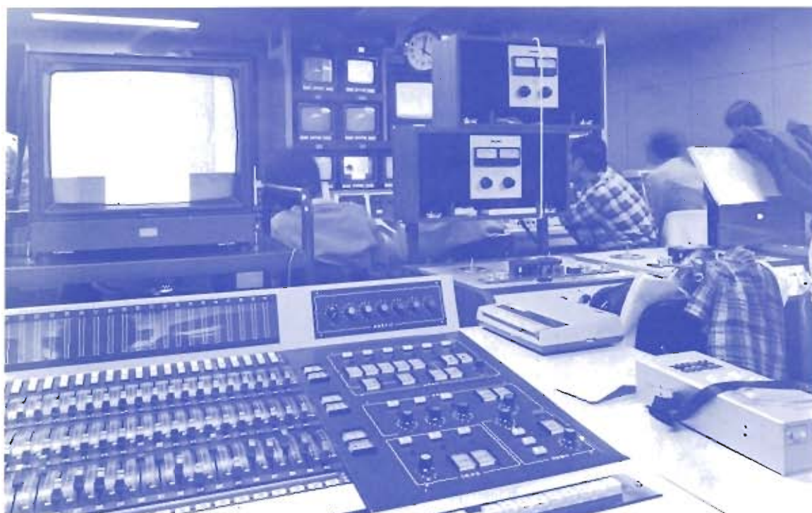
8F 副調整室内部
