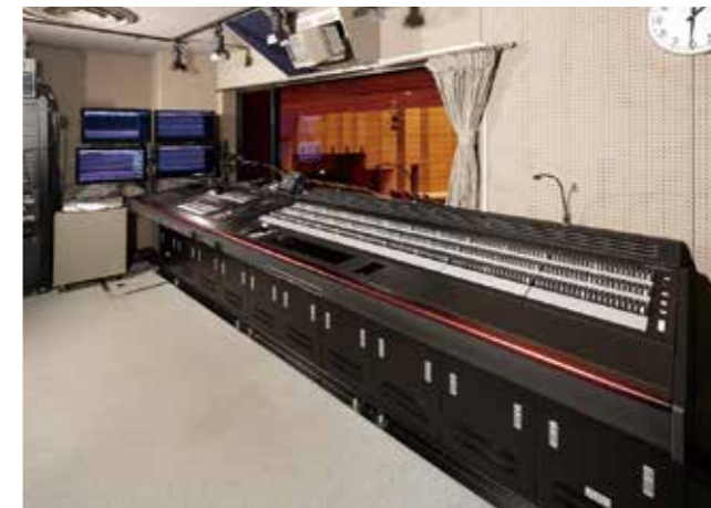
長野県県民文化会館 [ホクト文化ホール] 大ホール (据置型) HOKUTO Culture Hall 長野県長野市 Nagano city, Nagano pref
