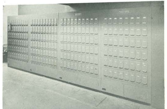
○ S C R ユニットラック盤
