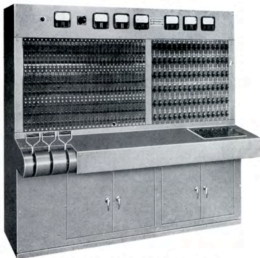
Fig 20 ラジオ東京Dスタジオ設置操作配電盤
