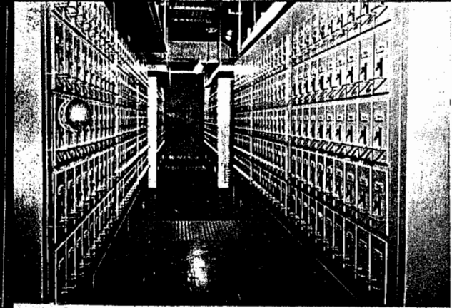
● SCRユニットラック盤
