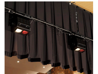
ボーダーライトとして設置された LEDフラッドライトLBC-WC
