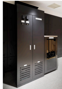
小ホール 照明用主幹盤/ 制御信号パッチ盤
