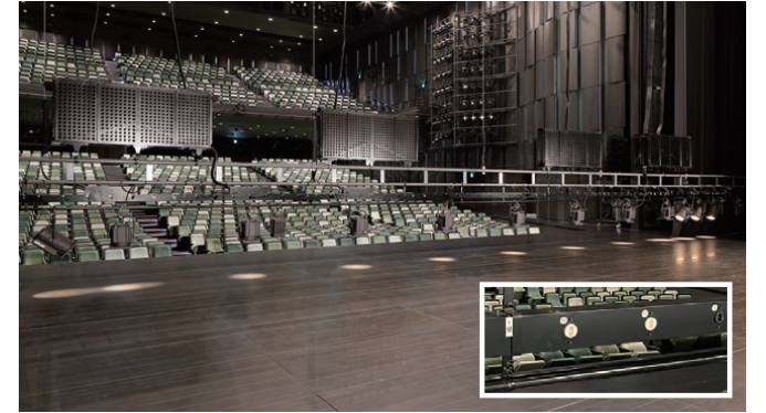
第1サスペンションライト・フライダクトに設備された直/調切替回路の白色コンセント
