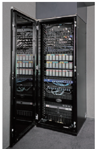
制御信号パッチ盤・光信号制御ユニット
