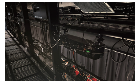
ユードムホール ブリッジライトに取り付けられた4ch移動型直ボックス
