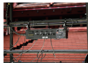
ライトブリッジに設備された4ch移動型調光器(上)と4ch移動型直ボックス(下)
