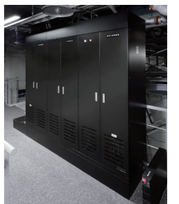
キャットウォークに設置された照明主幹電源盤
