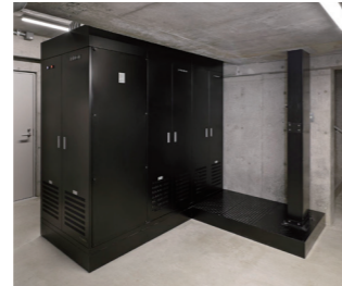
フロア電源盤
