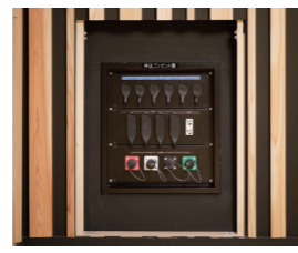
持込コンセント盤
