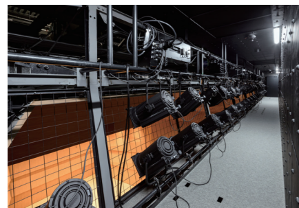
ホール 第1シーリングライト *iv
