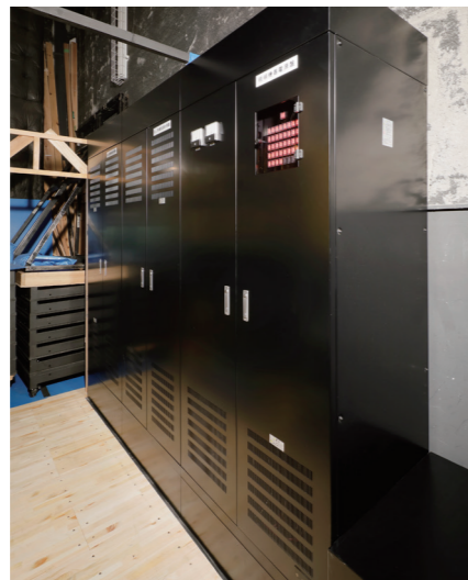
照明機器電源盤
