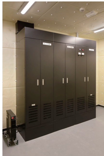
主幹電源盤・分岐盤
