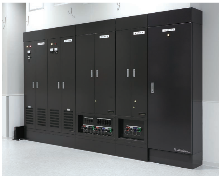
調光直電源盤・照明電源盤
