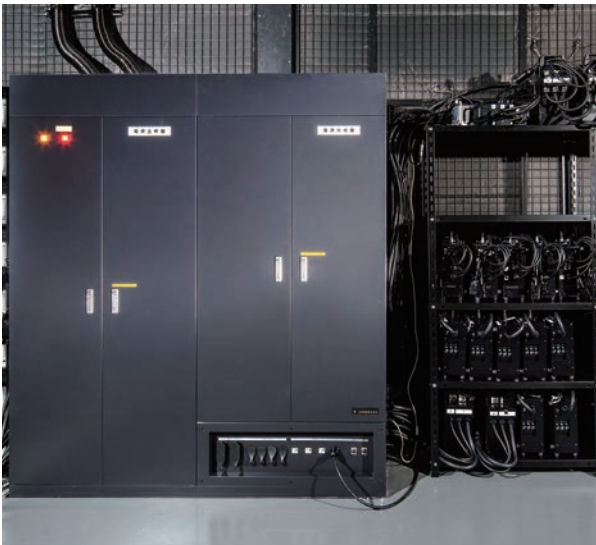
下手奥電源盤
