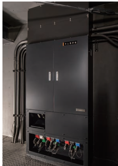
下手ギャラリー 持込機器用電源盤
