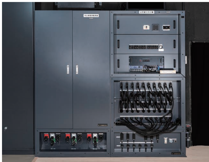
持込機器用電源盤、上手袖コンセント盤
