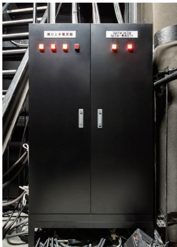
持込機器用電源盤
