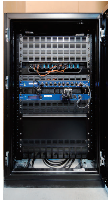
光信号制御ユニット盤
