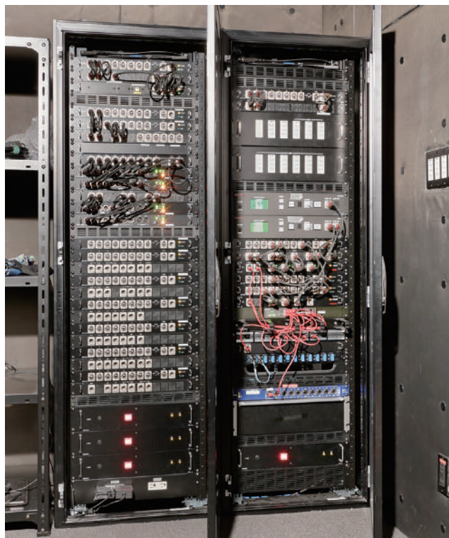
制御信号パッチラック
