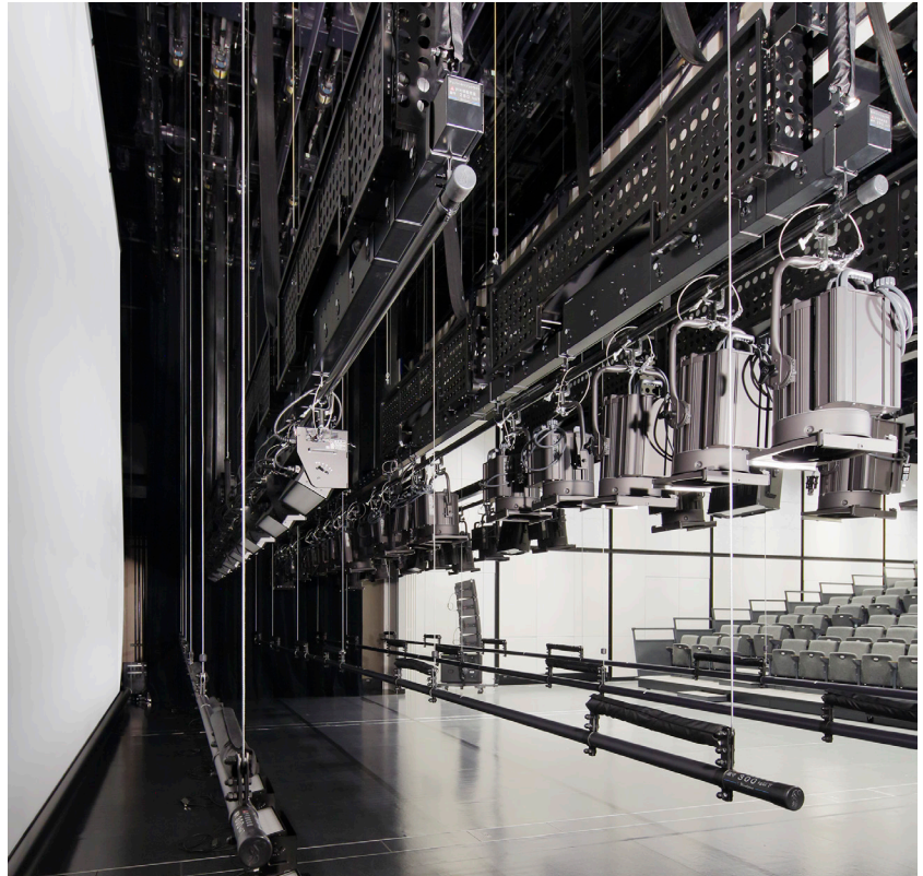
ステージ部の照明設備
