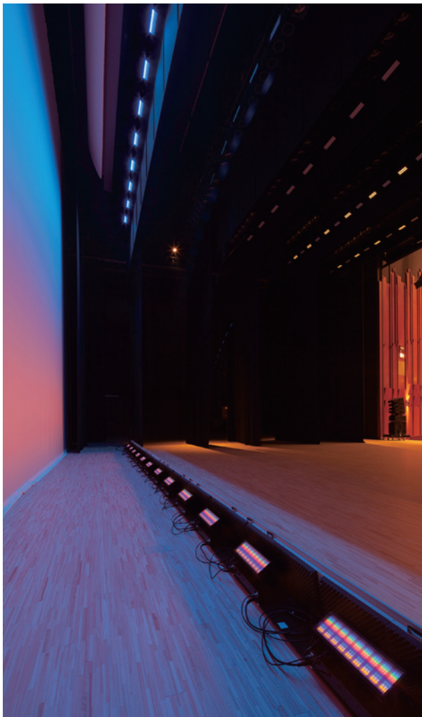
ホリゾントライトに設備された LED フラッドライト
