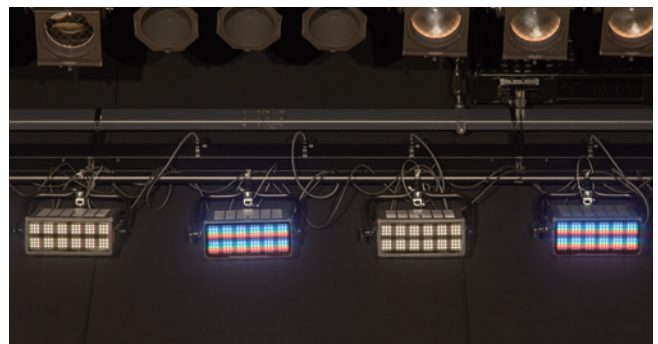
ボーダーライトに設備された LED フラッドライト
