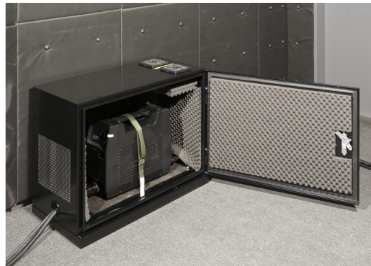
整流器防音ボックス
