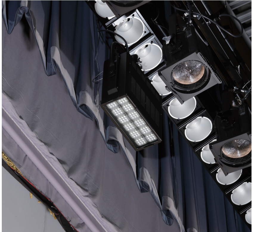
ボーダーライトに共吊りで設置されたLEDフラッドライトLEF2型4M-WW
