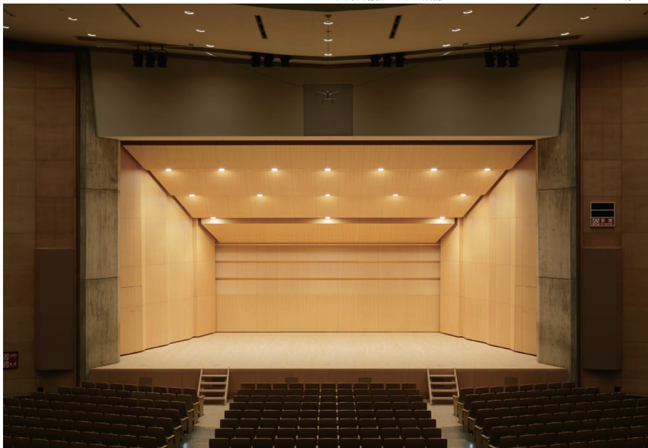
天井反射板ライトに設備された LED ダウンライト DDL 型 WW の明かり
