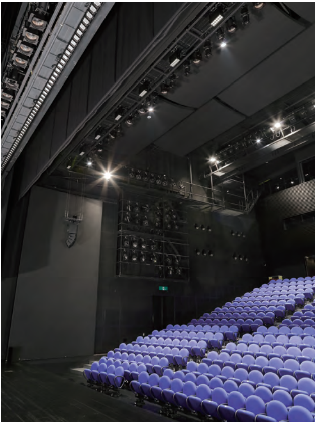
第1シーリングライトに設置されたLEF 2型 4 M - WW
