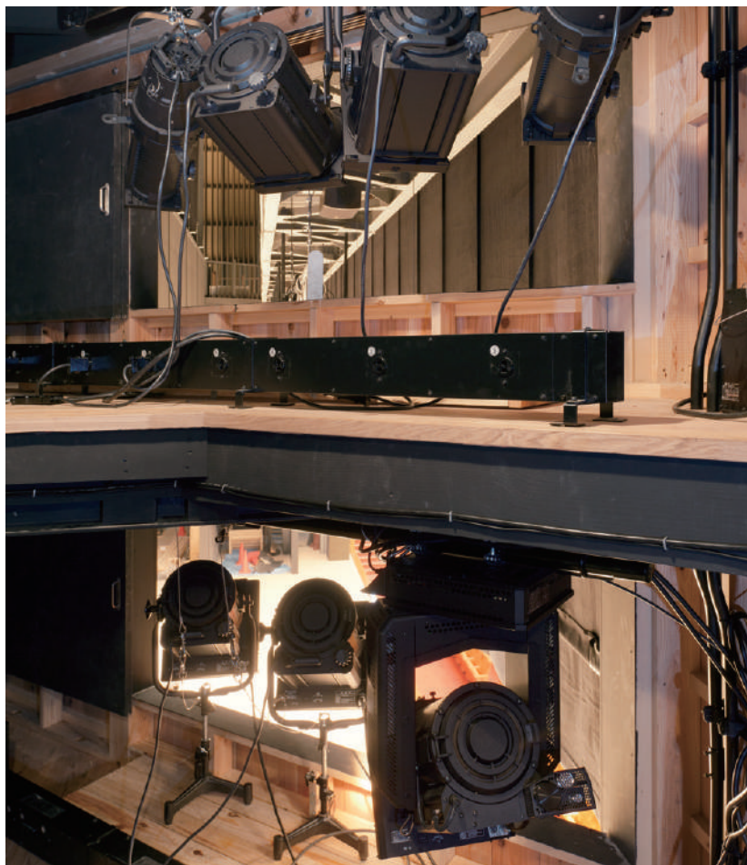
下手大臣柱の照明設備
