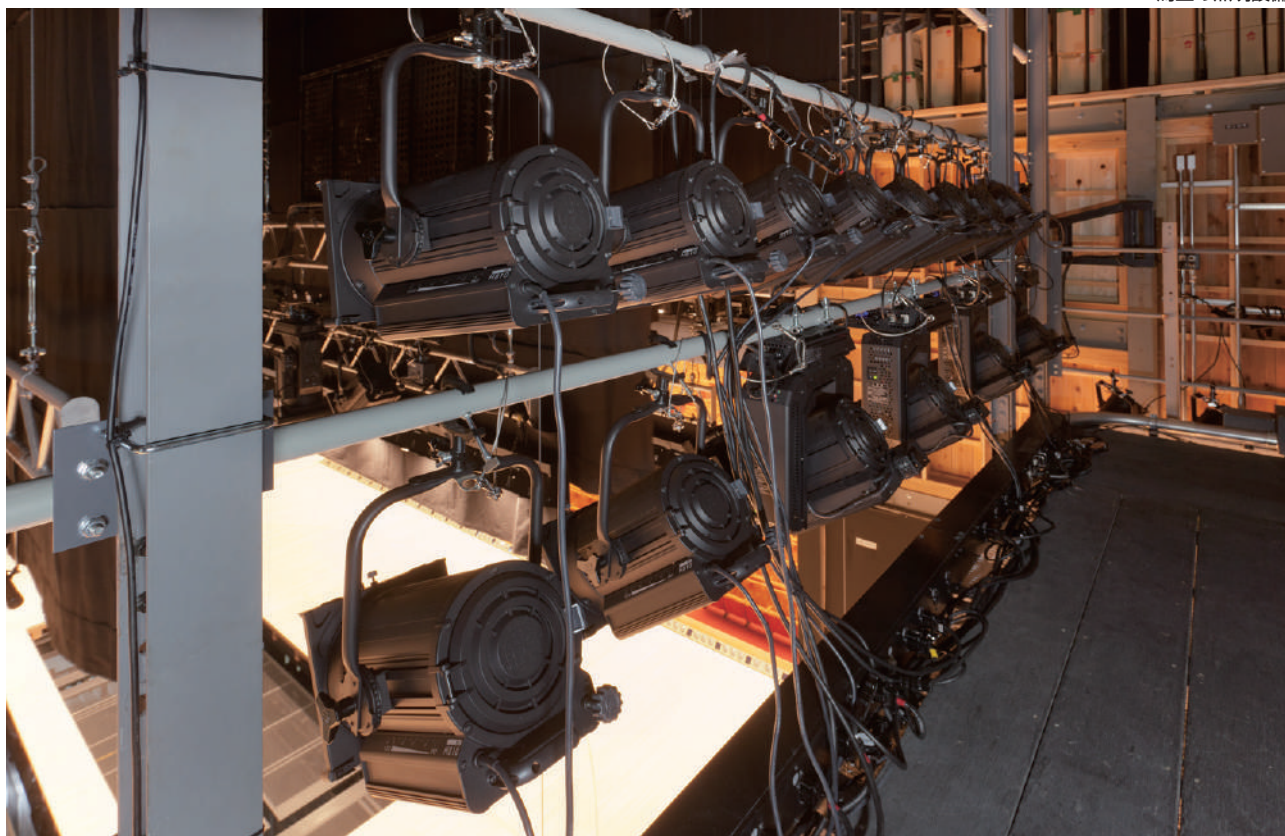
馬立の照明設備
