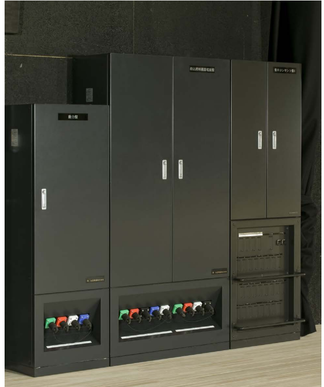
持込動力機器電源盤・持込照明機器電源盤・集中コンセント盤
