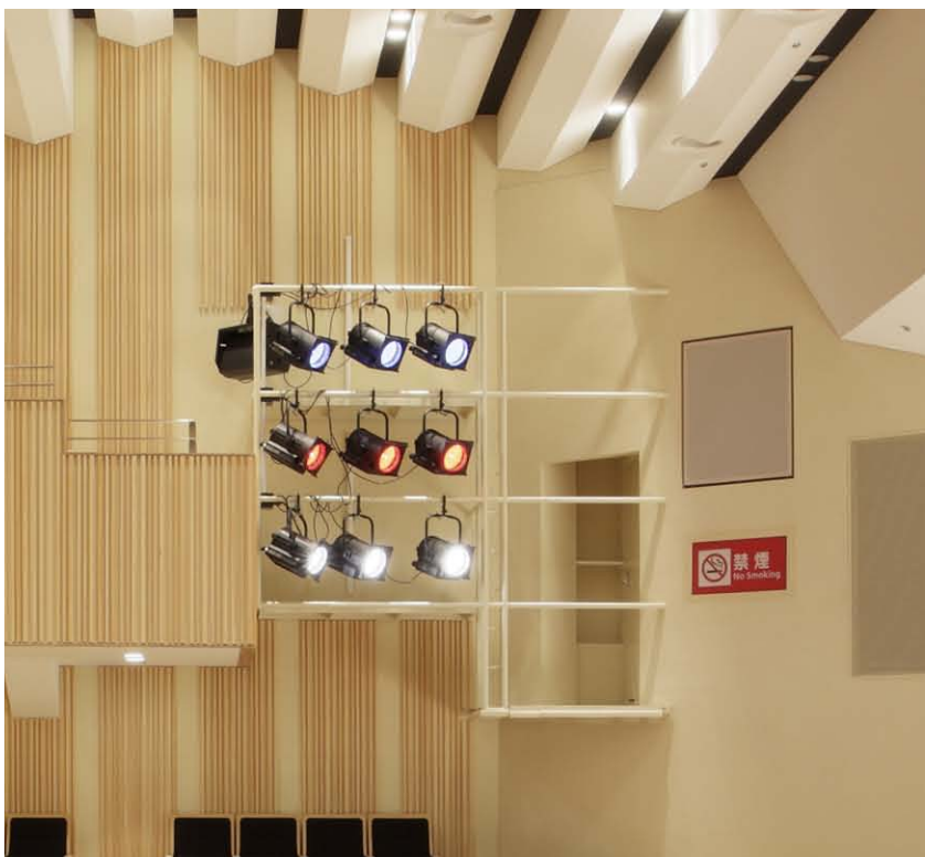
パイプで設置されたフロントサイドライト
