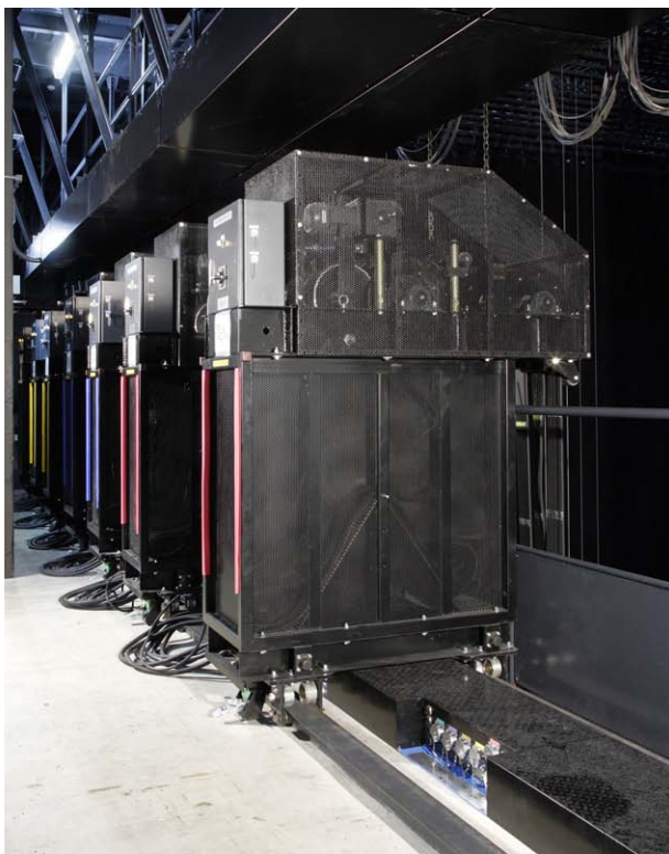
中劇場 移動型給電設備
