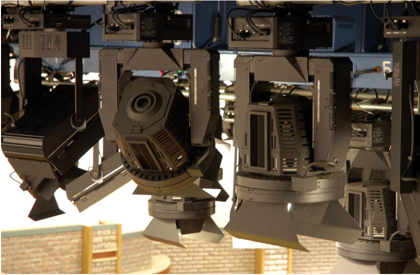
ライトバトンに設置されたリモコンスポットライトと蛍光灯リモコンフラッドライト
