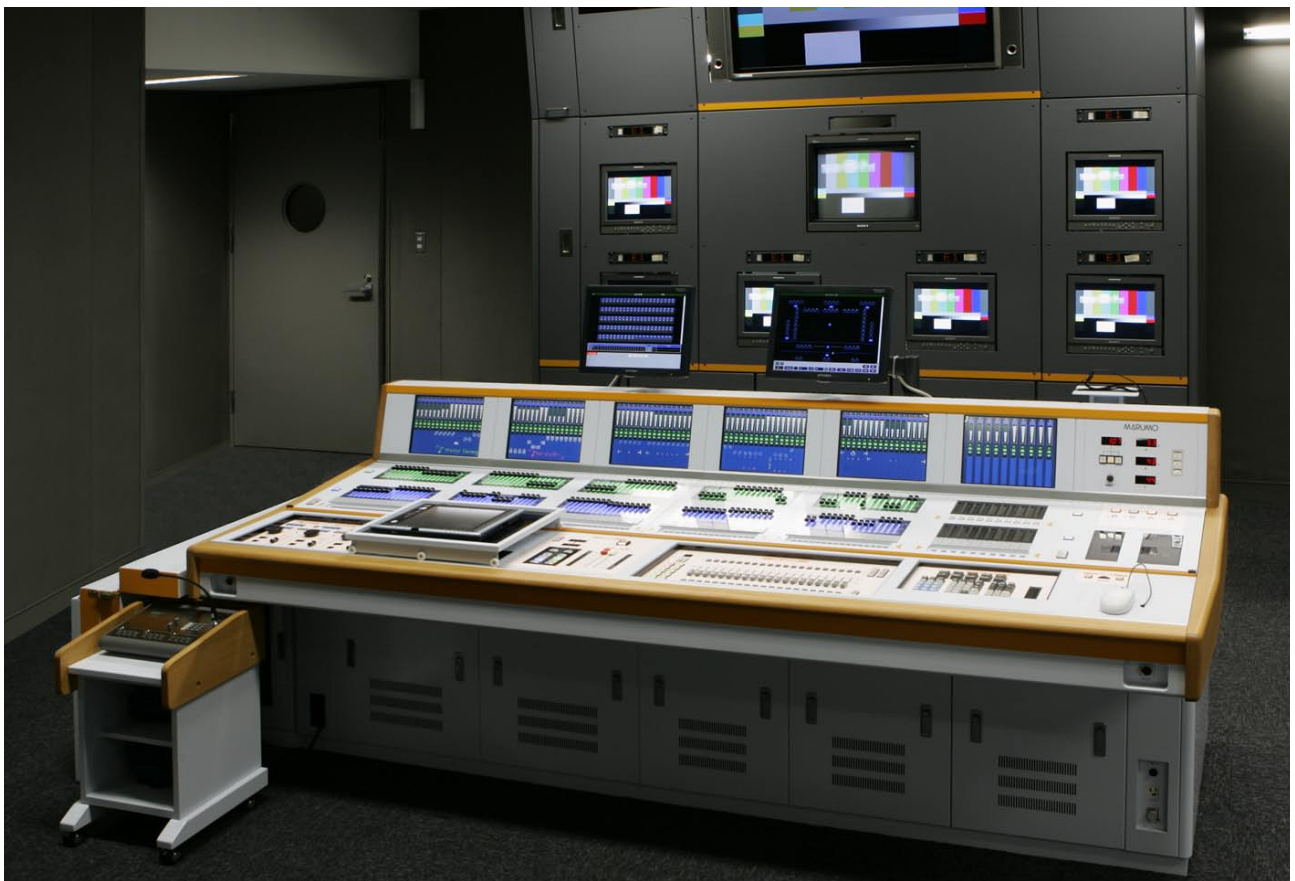
Aスタジオ副調整室 調光操作卓
