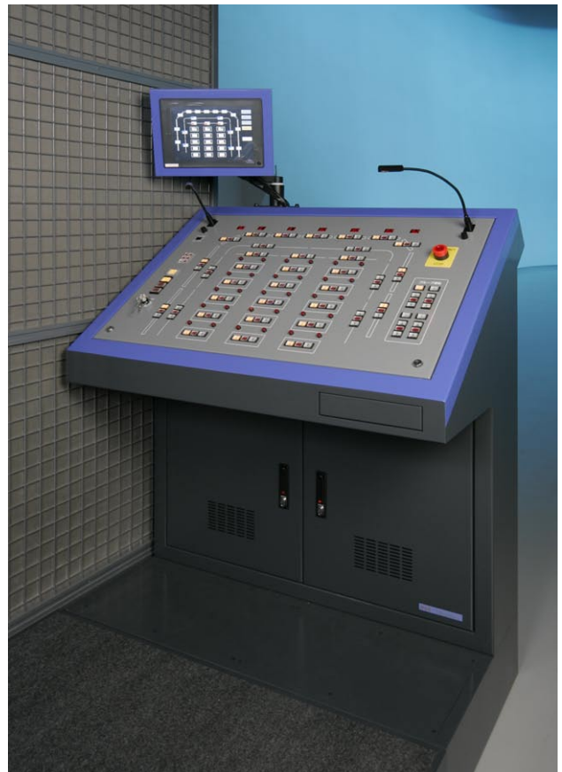
Bスタジオ 照明ボタン操作盤
