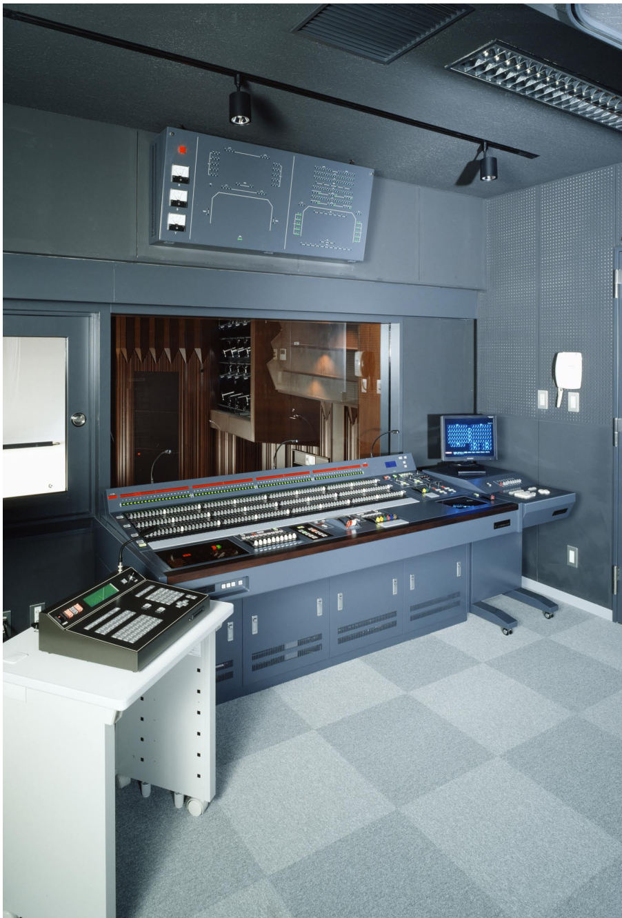
中ホール [あさぎり] 調光操作室 調光操作卓
