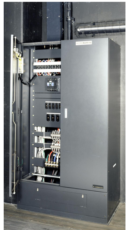
輝きホール 持込照明機器電源盤
