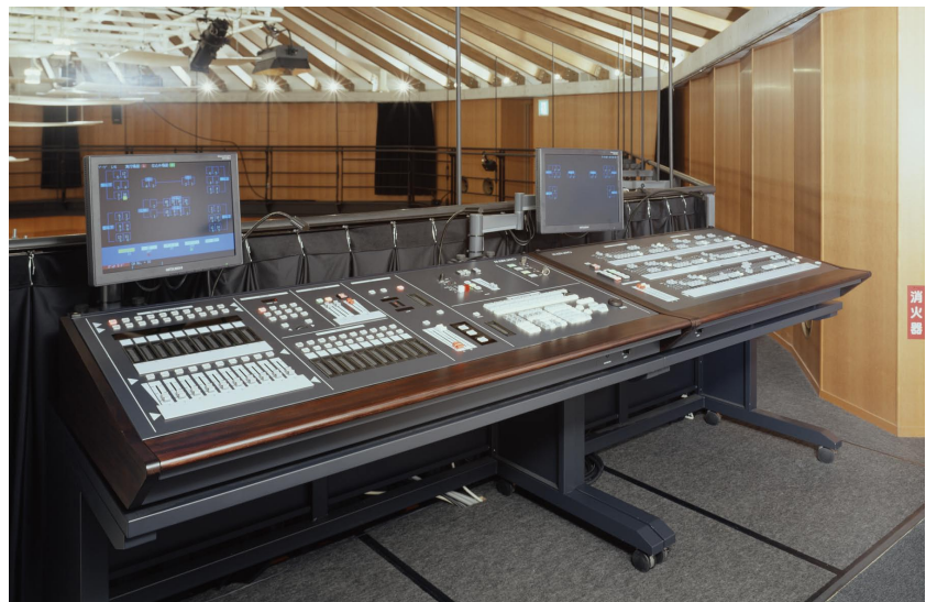
響きホール調光室 調光操作卓
