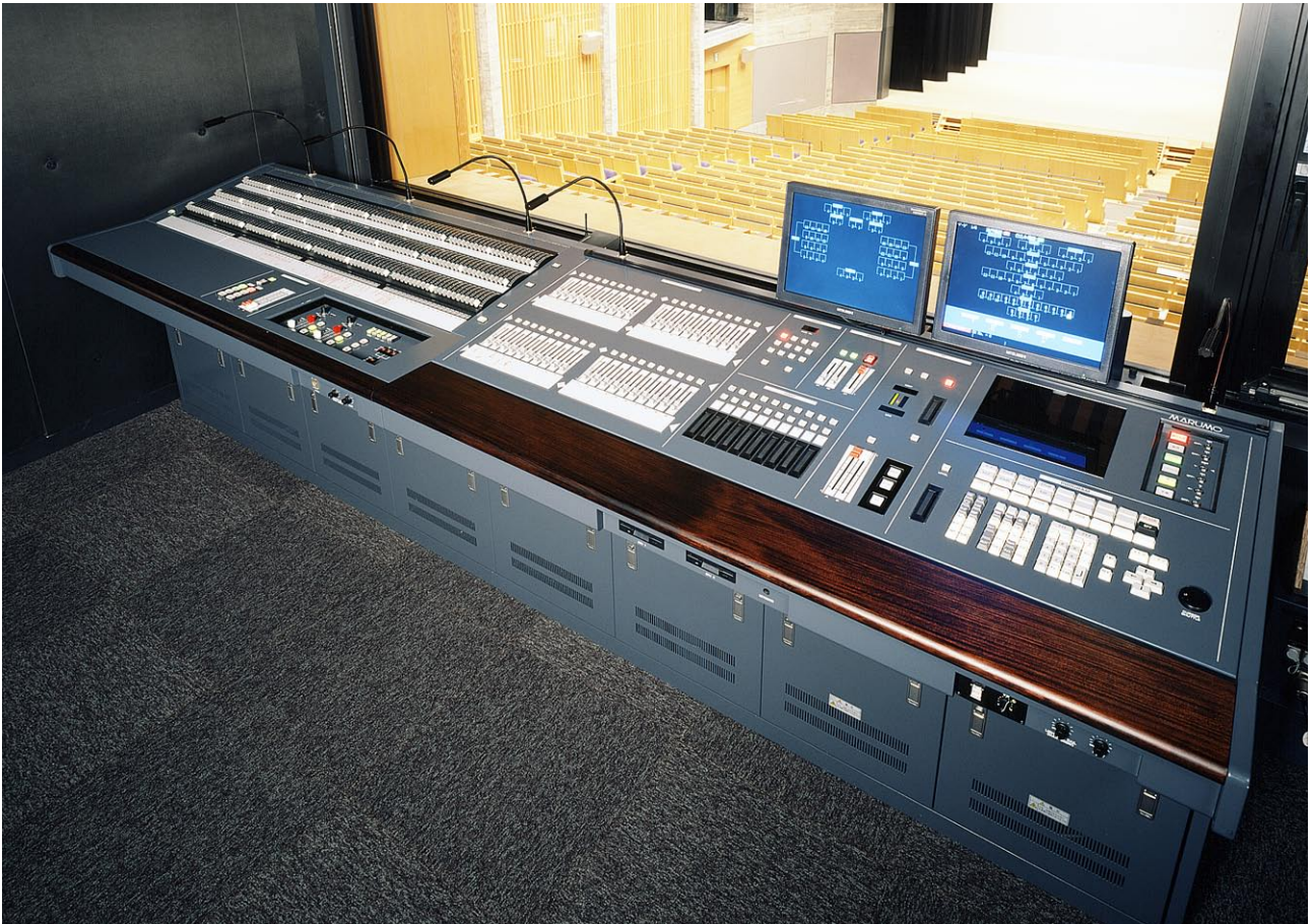
小ホール調光操作室 調光操作卓
