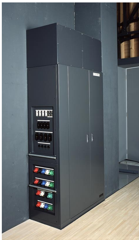
大ホール 舞台下手袖持込照明機器用電源盤
