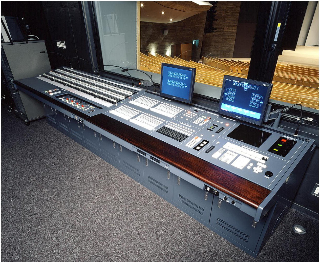
大ホール調光操作室 調光操作卓
