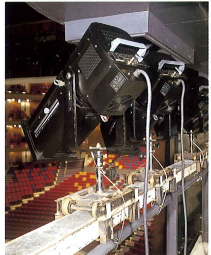
ギャラリーに設置されたレールスタンドとRJ714SX
