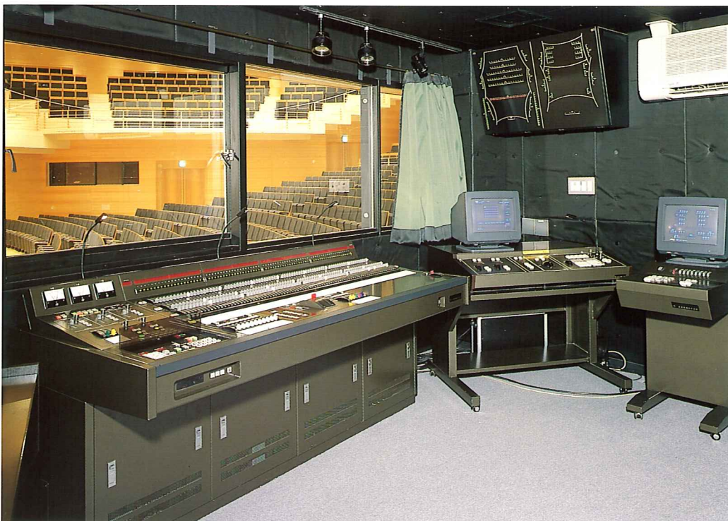
コンサートホール調光室
