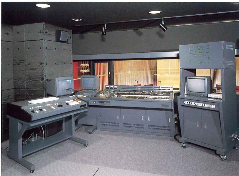
コンサートホール調光室
