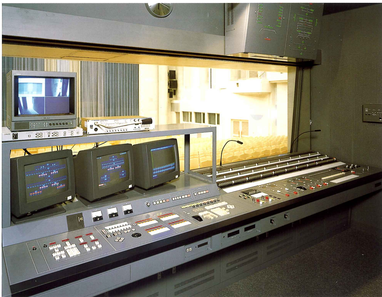
コンサートホール調光室
