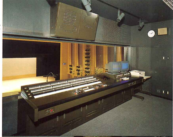
響ホール調光室
