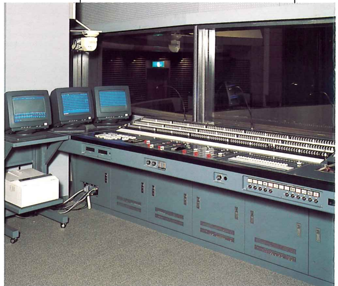
中ホール調光室(マリオネットⅡ型調光操作卓)
