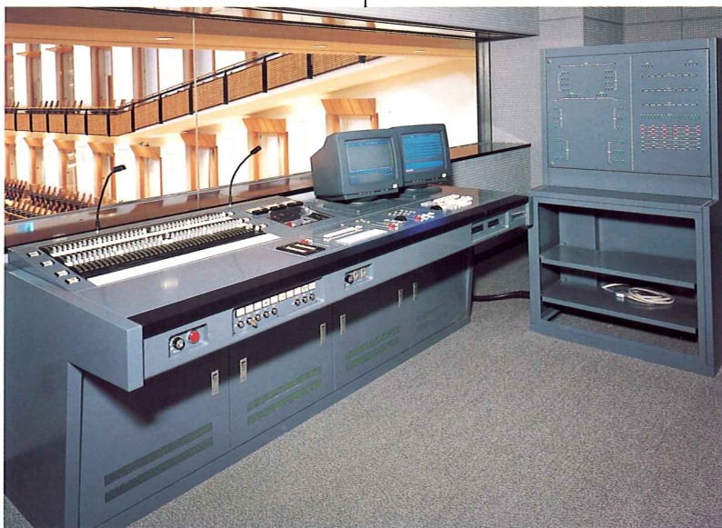
大ホール調光室 〔マリオネットⅡX型調光操作卓〕
