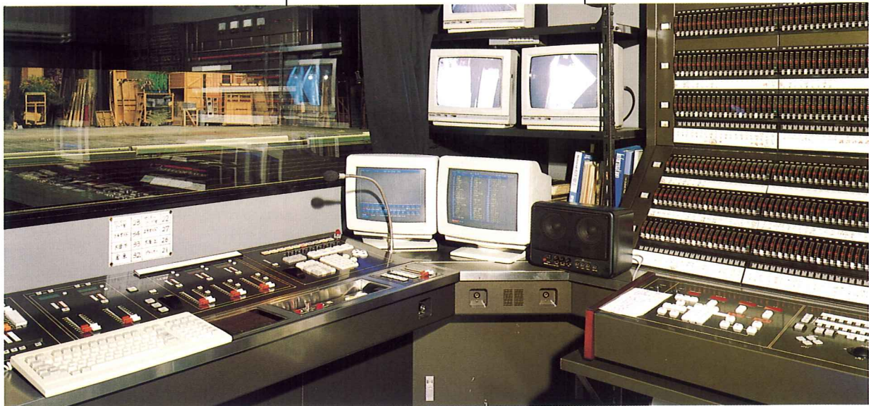
マリオネットII型照明操作卓
