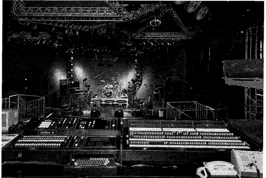
照明操作卓(μファイルII EX型調光システム)▲
