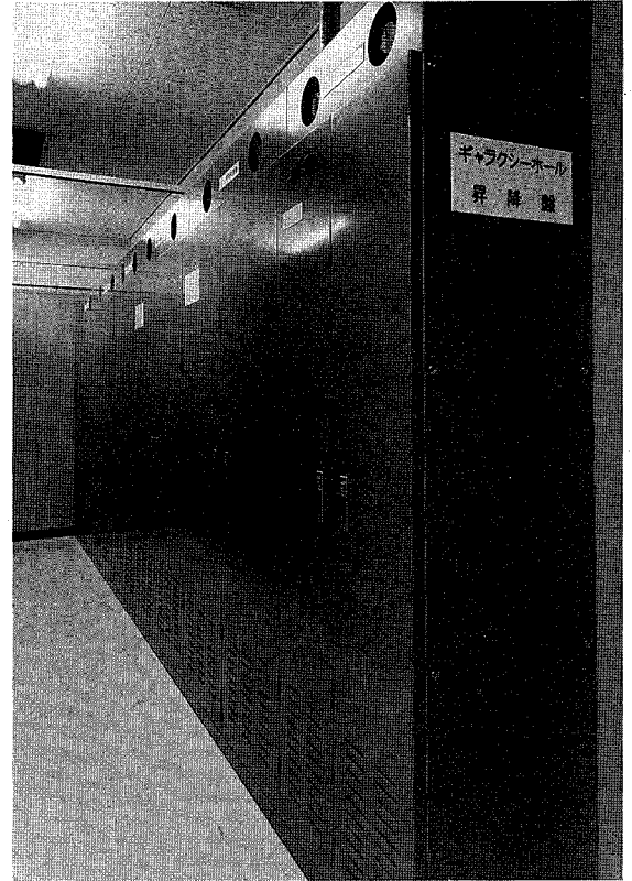
▲昇降操作制御盤
