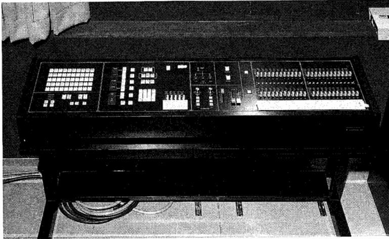
▲大宴会場の照明操作卓
