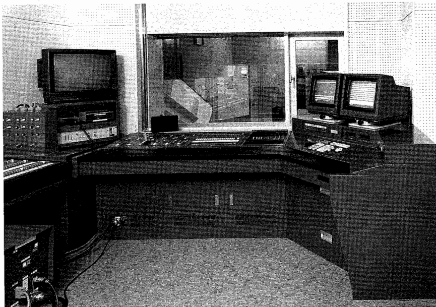
▼メインホール調光室▼
