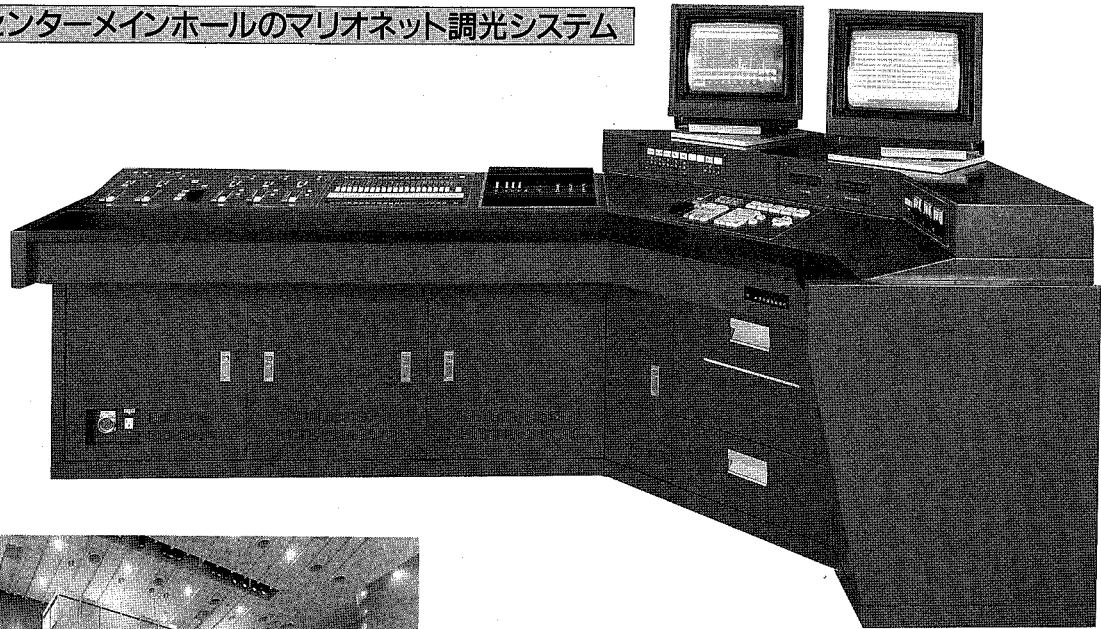
メインホール調光室▼
