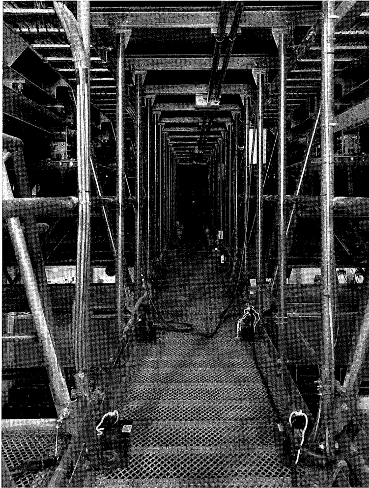
固定、走行ブリッジには、仕込みなどの作業がやりやすいように広いスペースが取られています。
