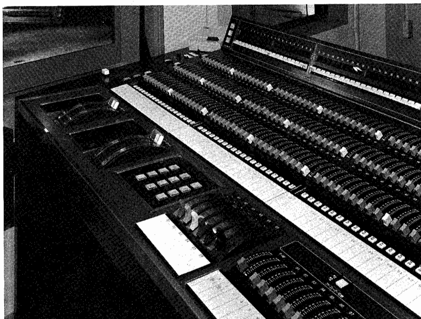
調光室の照明操作卓
