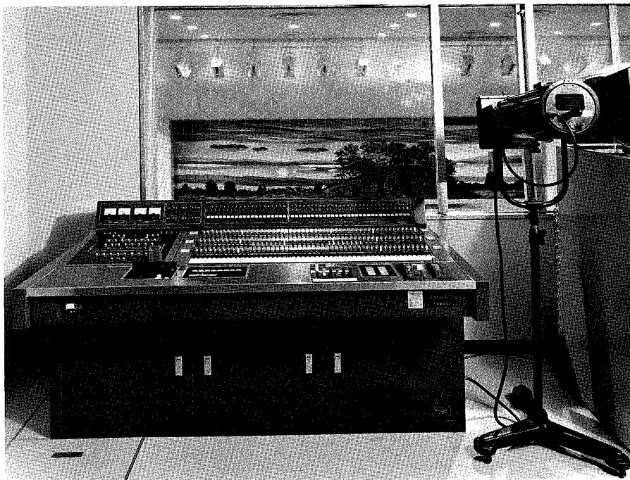
調光室の照明操作卓
