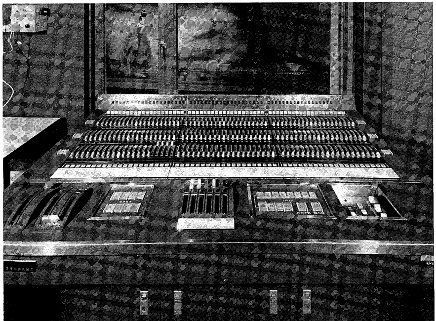
調光室の照明操作卓
