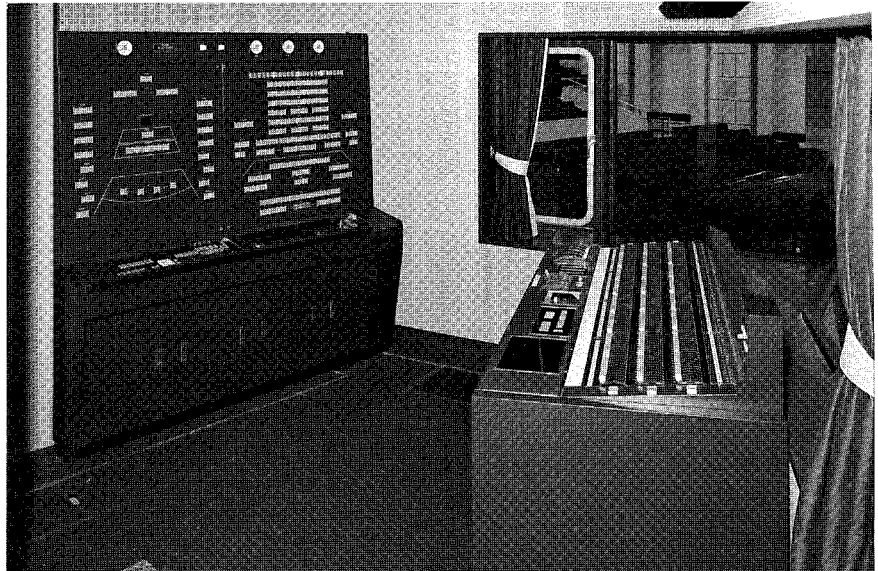
調光室の電子クロスバー選択操作盤
