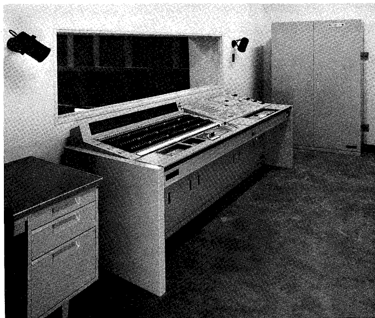
調光室・照明操作卓
