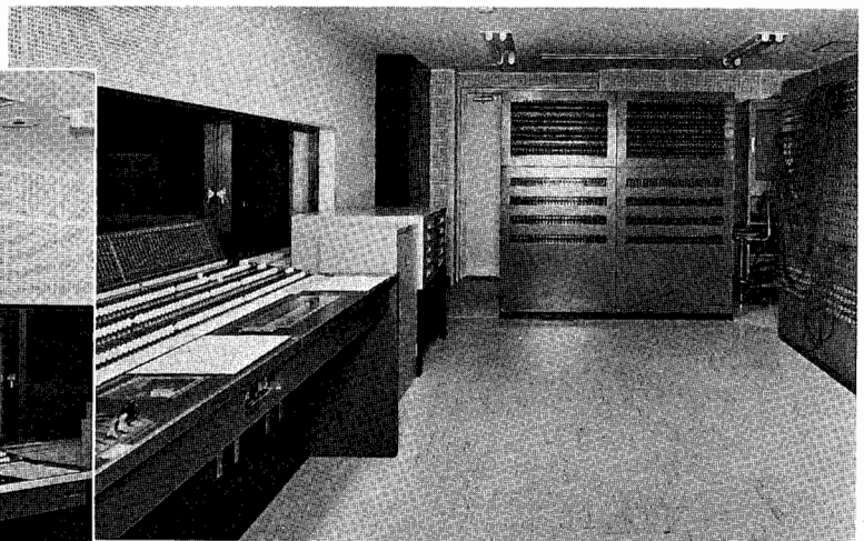
直調S.W.盤、強電パッチ盤
